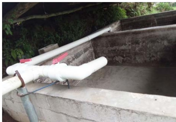
► Flujo de entradas de aguas mieles para tratamiento. Cordillera Apaneca Ilamatepec. Foto: CSC
