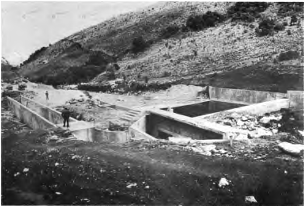
Del Rfo Blanco se ha captado el agua que servir para irrigar alrededor de 2.000 has. del Proyecto (Proyecto Quimiag-Penipe).
