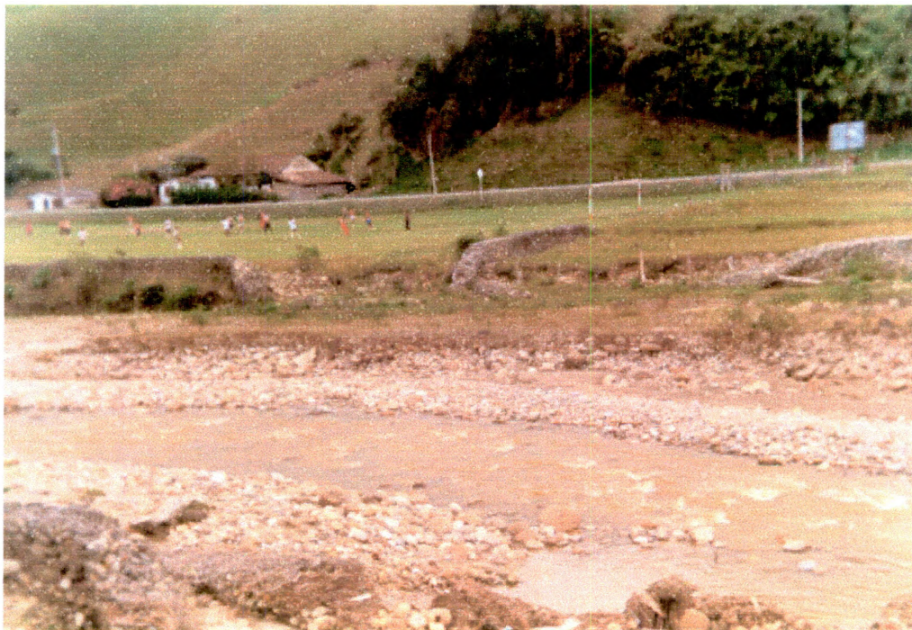
Destrucción de Gaviones, Aguas Arriba Dársena Canal D.
