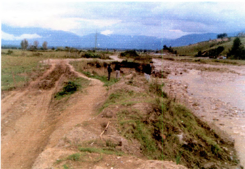
Debilitamiento carretable aguas arriba dársena, sobre Río San Pedro.
