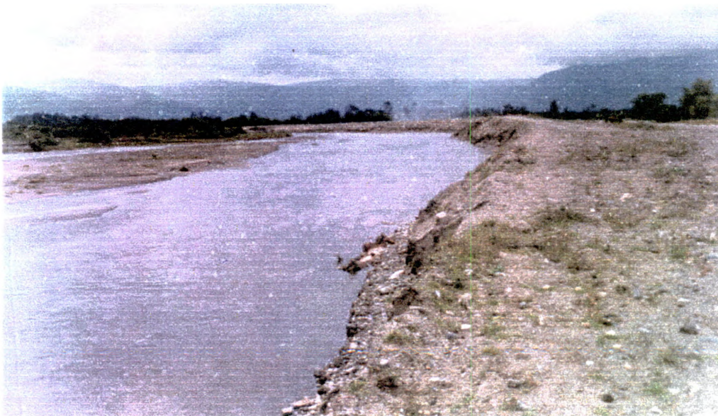
Dársena Canal A, Dique Erosionado.
