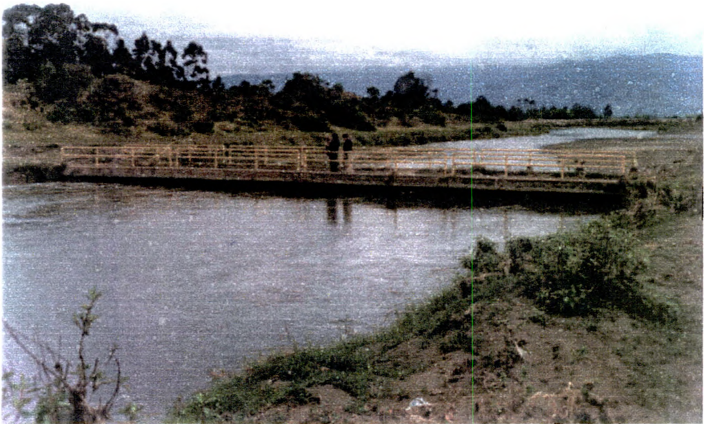
Puente Cercano al K0+000, Totalmente Colmatado.
