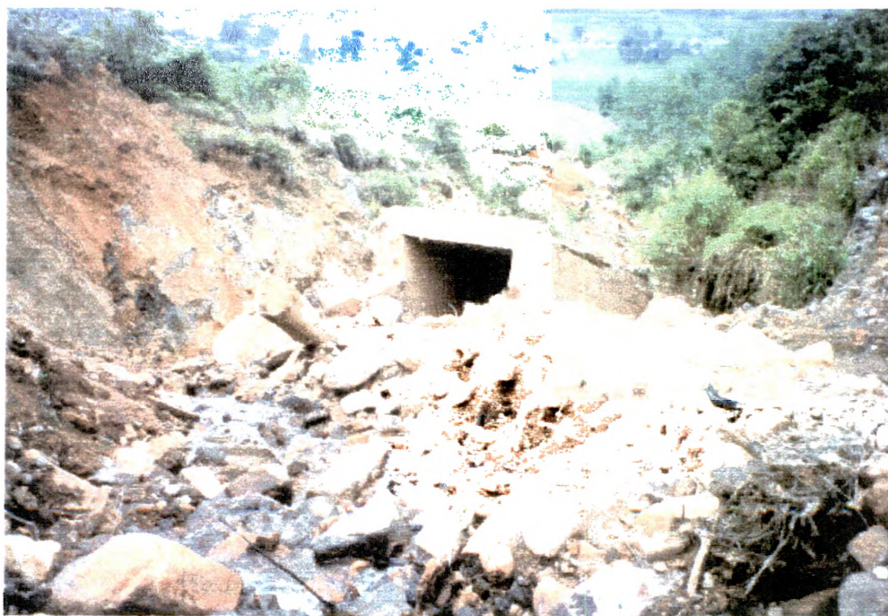
Box Arrastrado por Deslizamiento.
