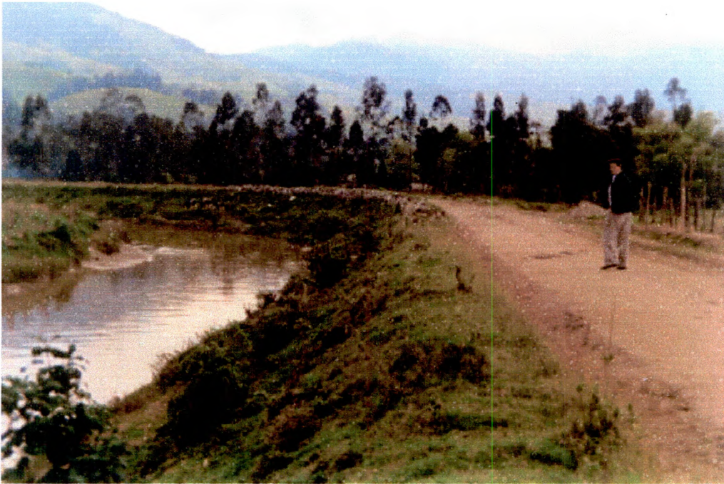
Dique carreteable con necesidad de realce.
