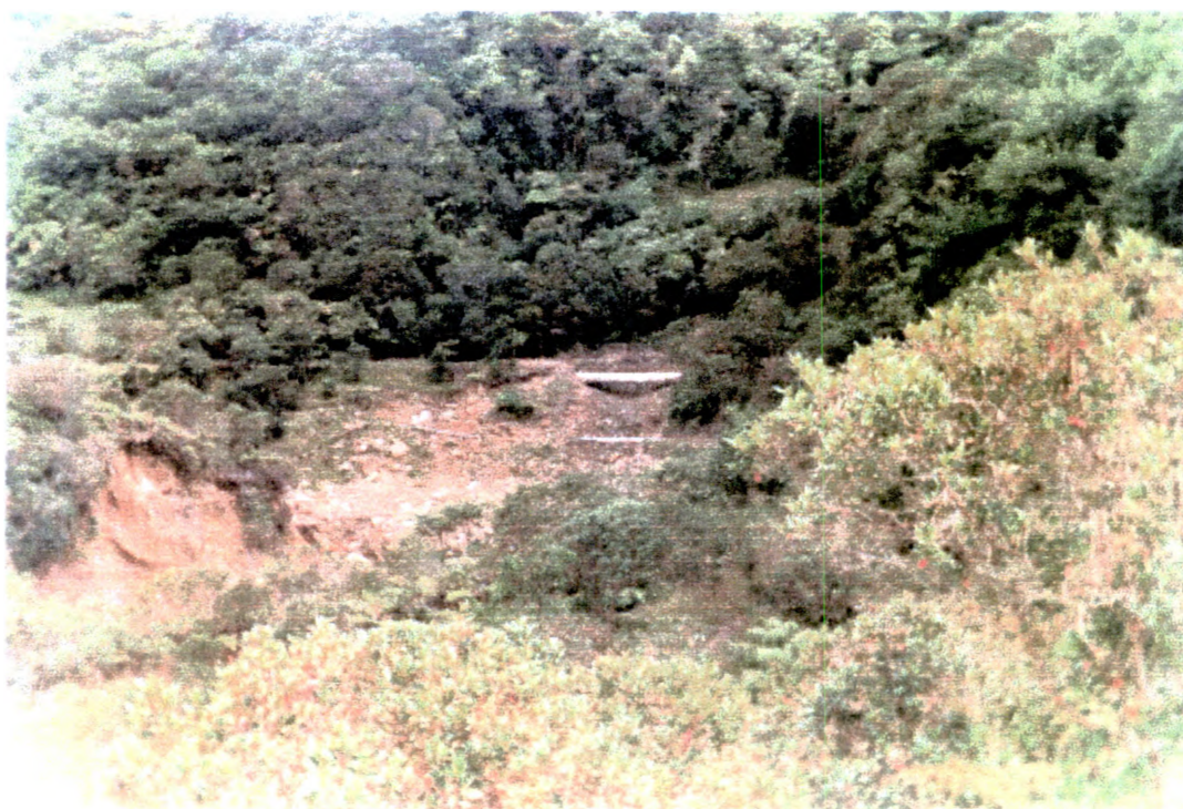
Conducción provisional a planta de tratamiento por destrucción del canal.
