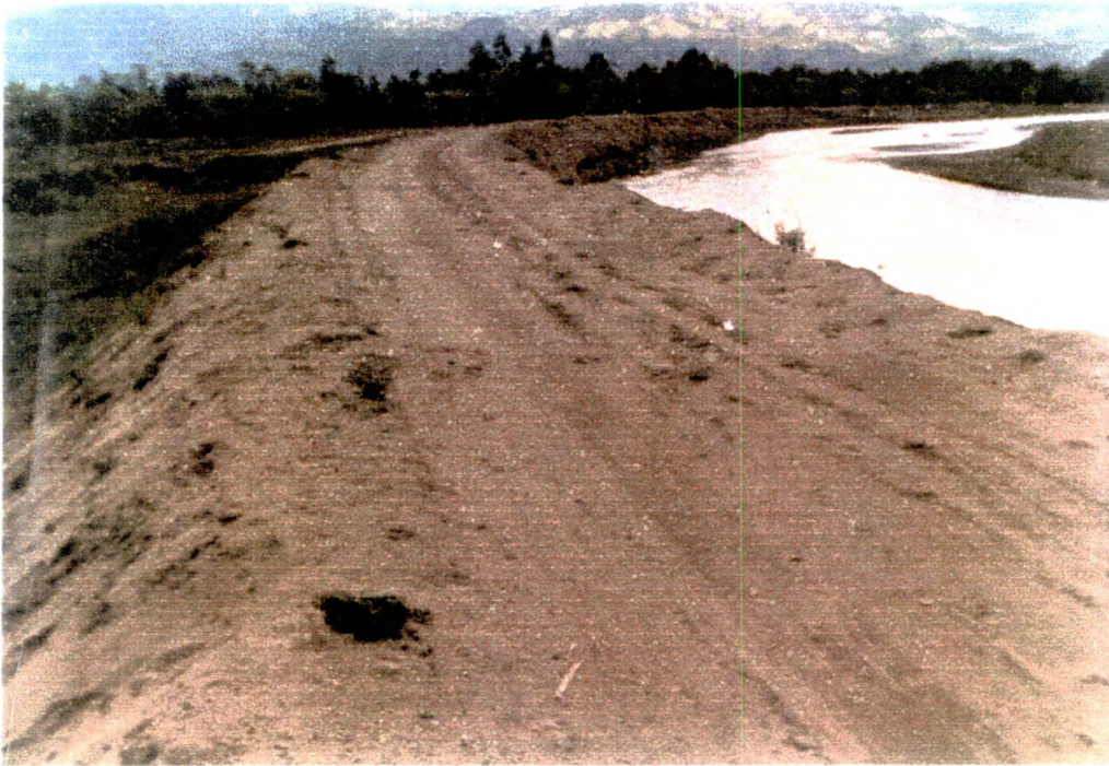
Dársena, Canal A. (Se puede observar el debilitamiento del dique)
