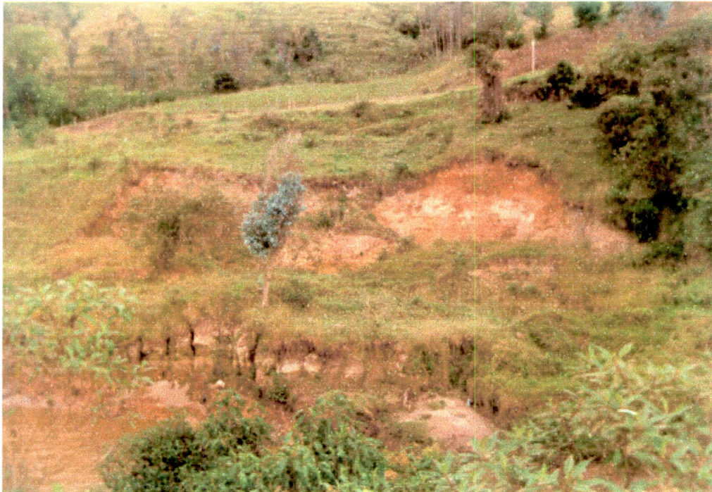
Desprendimiento sobre costado carretera a Pasto, Canal D.
