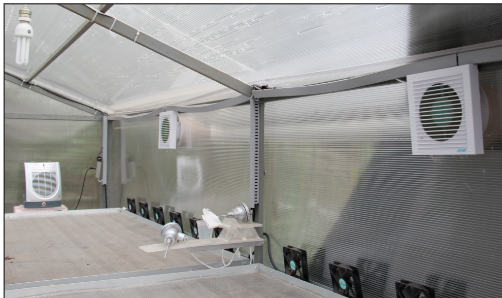
Termoventiladores, extractores y ventiladores dentro el módulo
