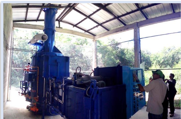
Después: Incinerador en operación el AIGL
