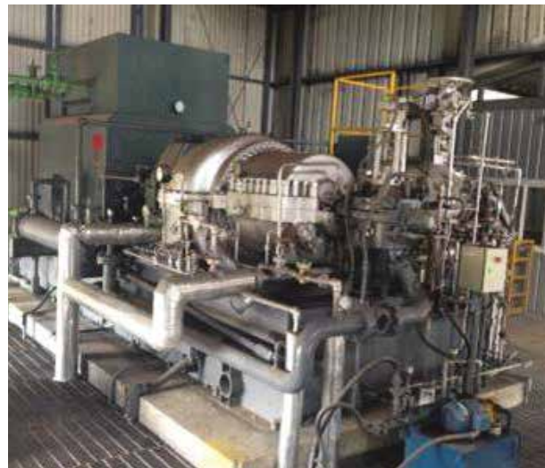
Turbo generador de vapor tipo condensante de la planta.
