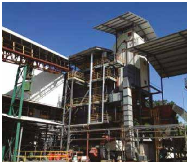
Caldera de alta presión de la planta principal de generación de energía con biomasa (4,5 MW).
