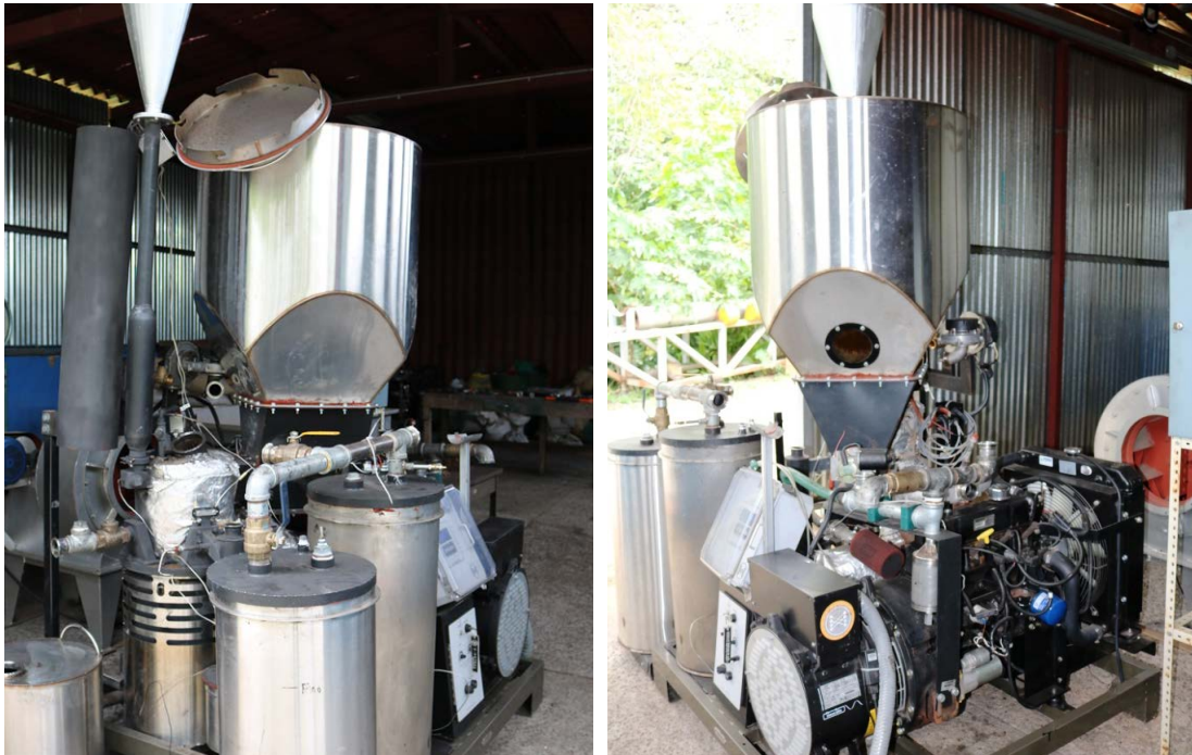
FIGURA 17. Gasificador para tratamiento de la pulpa y generador eléctrico con biogás.
