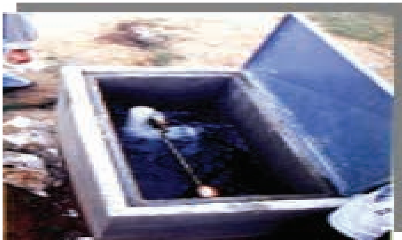
Tanque rompe presión con sus accesorios en funcionamiento
