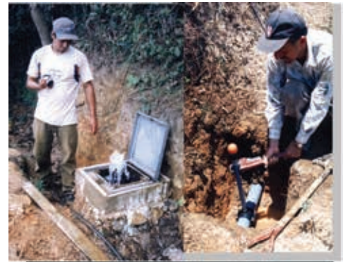
Caja con válvula de aire
