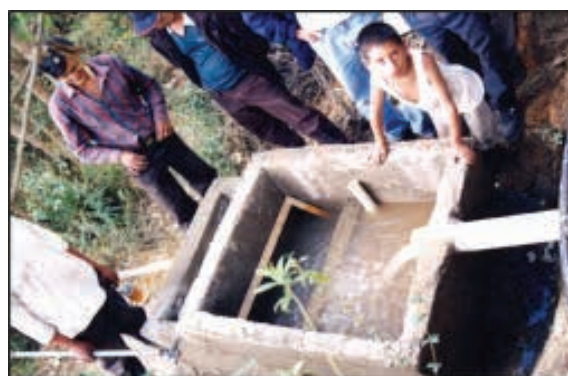
Captación pequeña en funcionamiento
