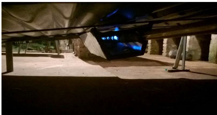
Ilustración 57. Quemador de biogás para la generación de calor en un deshidratador de alimentos en Paraguay
