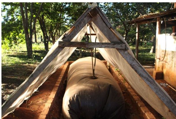
Ilustración 23. Biodigestor tubular instalado en el Centro de Capacitación y Tecnología Apropriada de la FCA-UNA
