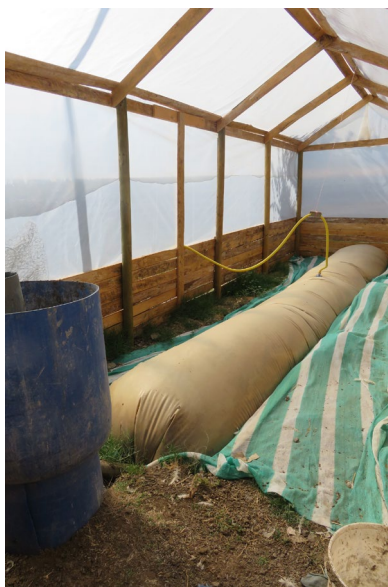
Ilustración 10. Biodigestor del INDAP instalado en la zona central, proyecto piloto de Lampa, período 2015-2016
