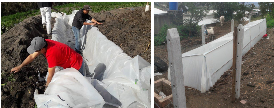
Ilustración 87. Instalación de un biodigestor en la provincia de Tungurahua con fines de aprovechamiento productivo
