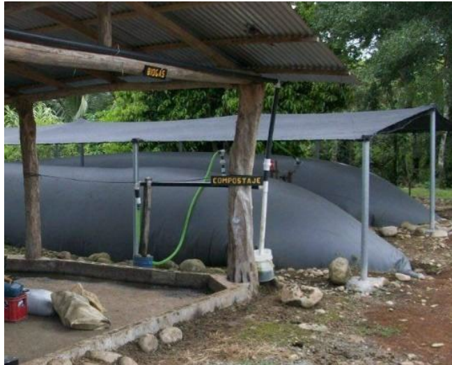
Ilustración 3. Primer biodigestor de geomembrana de PVC en Costa Rica
