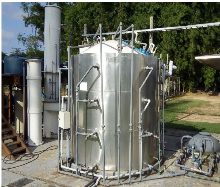
Ilustración 29. Biodigestor anaerobio instalado en la pMethar/UFMG
