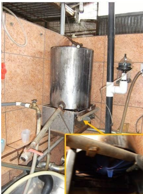
Ilustración 52. Calefacción de agua para la limpieza de equipos de producción de leche en Costa Rica.
